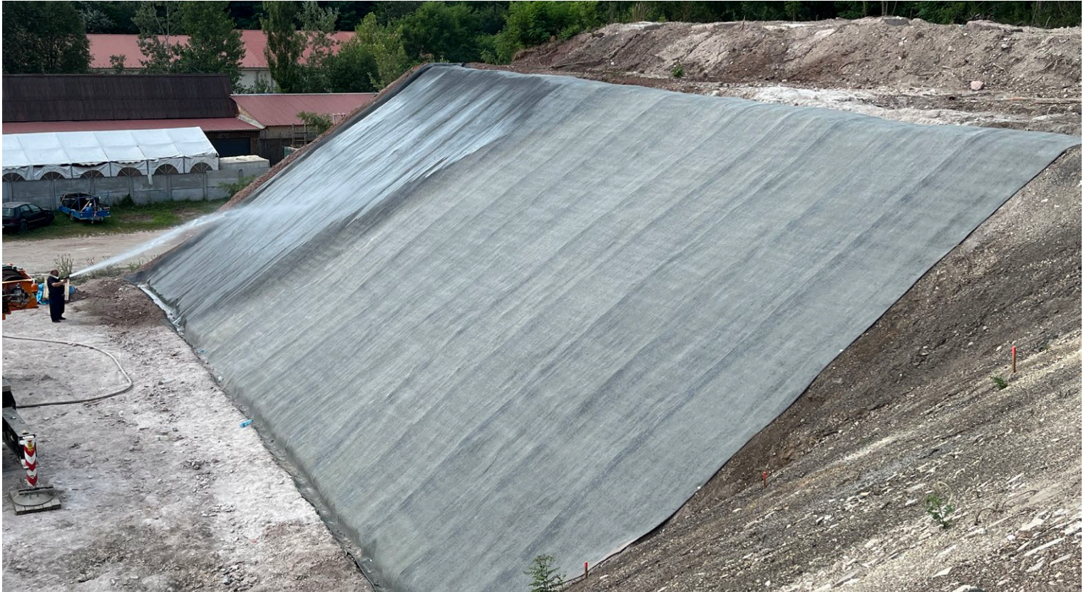
CCX-M ® vízkezelése tűzoltó járműből locsoló-tömlővel
